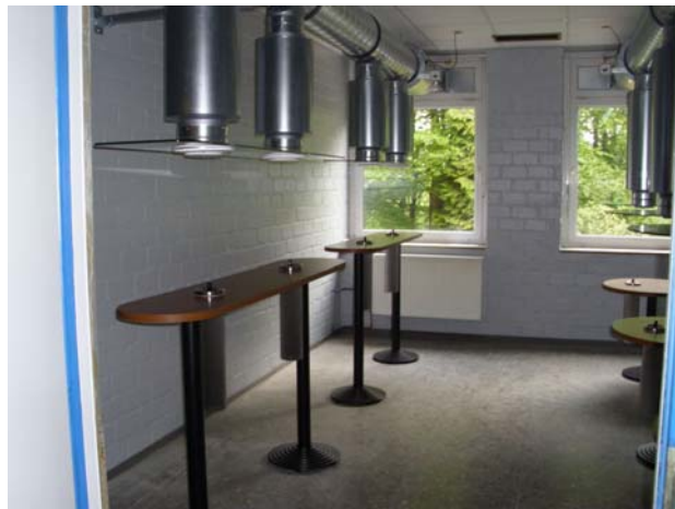
Unten: Behinderten-Zentrum - 2 Doppel-Düsenplatten mit Stehetischen und 3 Einzeldüsenplatten mit Sitztischen für Rollstuhlfahrer (oben).
