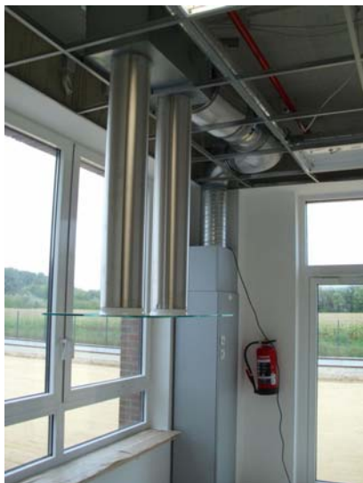
Pausenraum: Doppel-Düsenplatte mit Umluftfilteranlage SC 600 UL-S- (unten)
